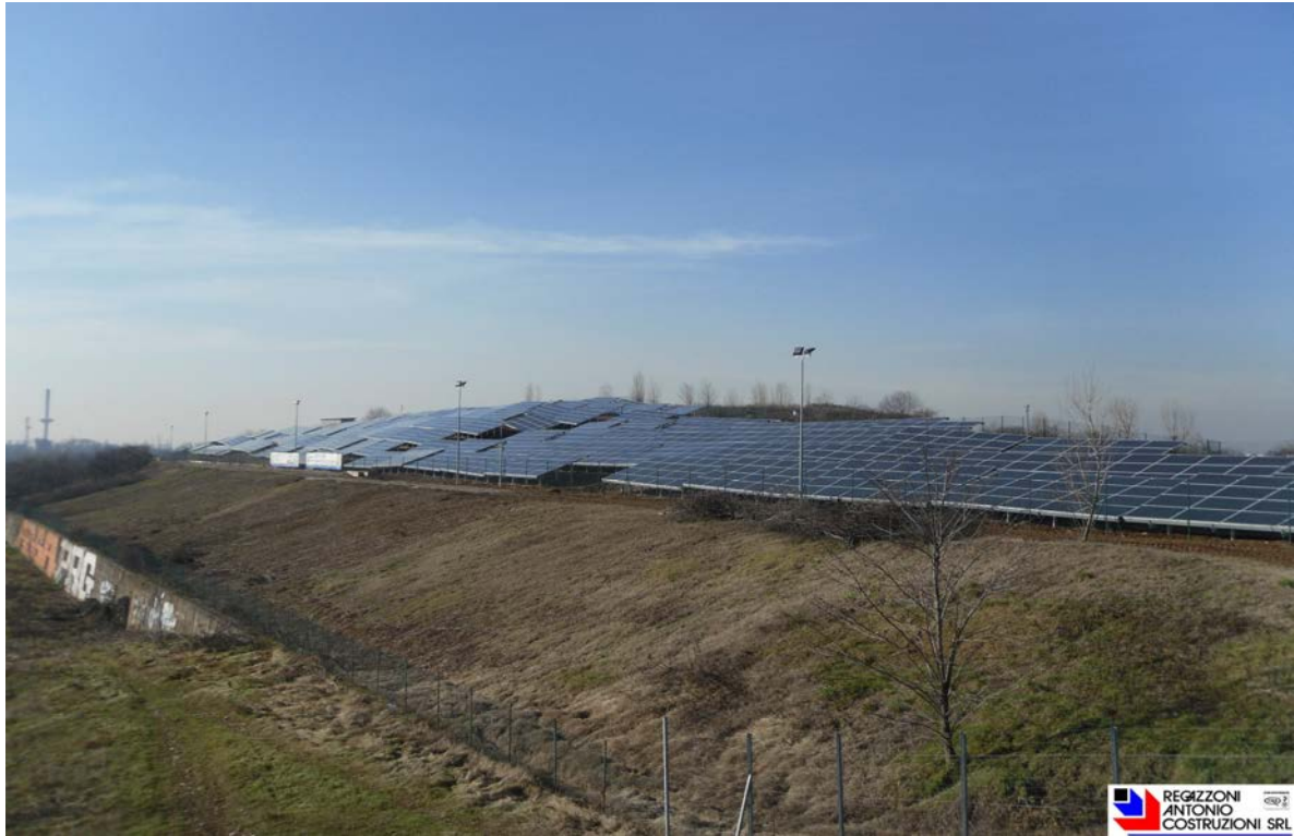
Impianto fotovoltaico - Osio Sotto (BG)
