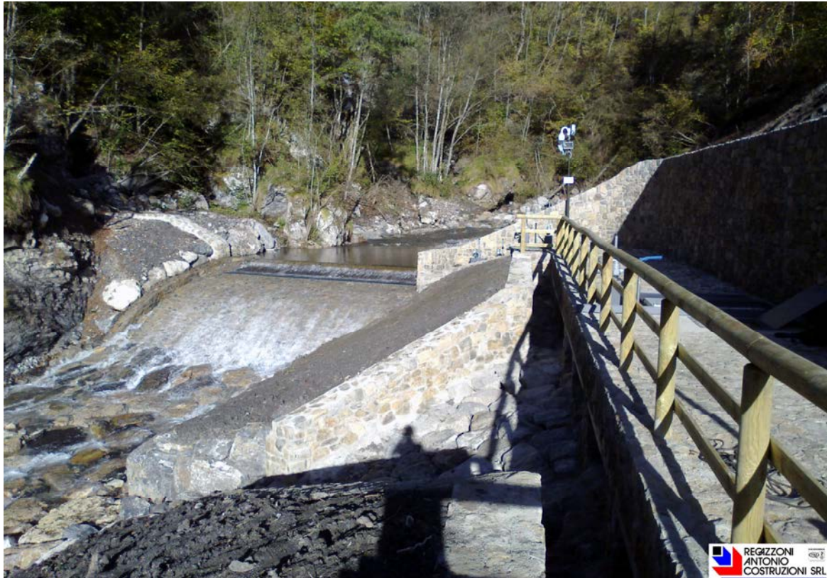
Impianto di presa – Val Taleggio (BG)
