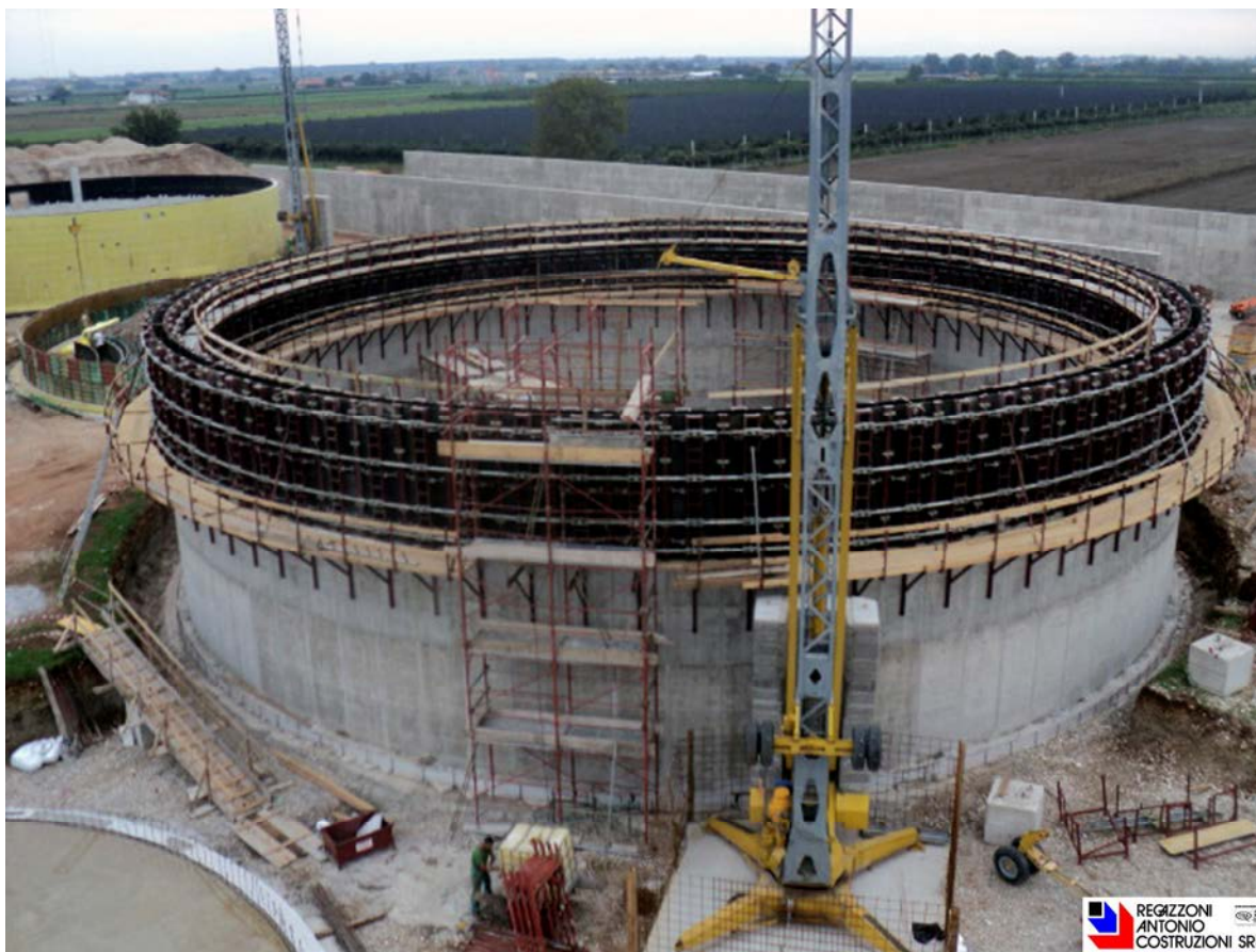
Impianto biogas - Roverbella (MN)
